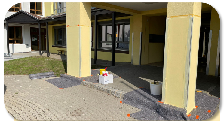
Instandhaltung von Gemeindegebäuden
